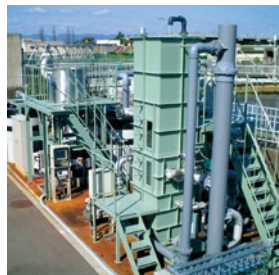
繊維ろ過による合流式 下水道改善処理システム
